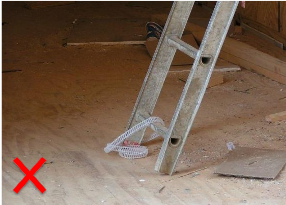
Escalera de extensión con un pie y protectores de pie faltantes. Esto parece ser la porción superior de una escalera de extensión que ha sido desarmada.
