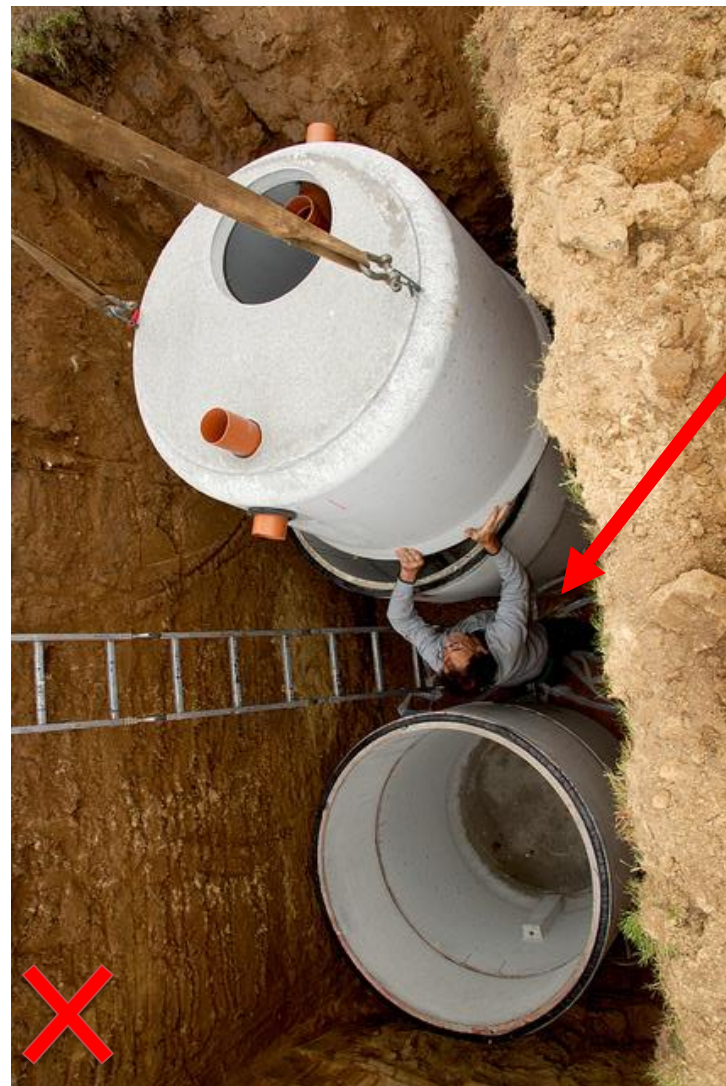
Hombre en excavación sin protección instalando un tanque séptico. Existen serios riesgos de derrumbe en esta situación. (*1)
